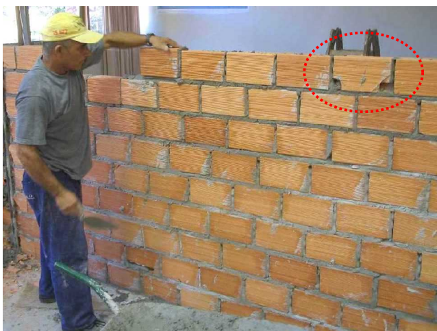
Figura 12: Alvenaria executada com tijolo seco. Observar a diferença de tonalidade entre a argamassa das fiadas e os respingos sobre os blocos. Atentar também para o bloco danificado.
