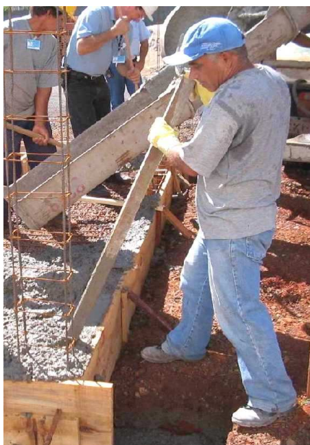
Figura 17: Adensamento de concreto feito sem equipamento adequado.
