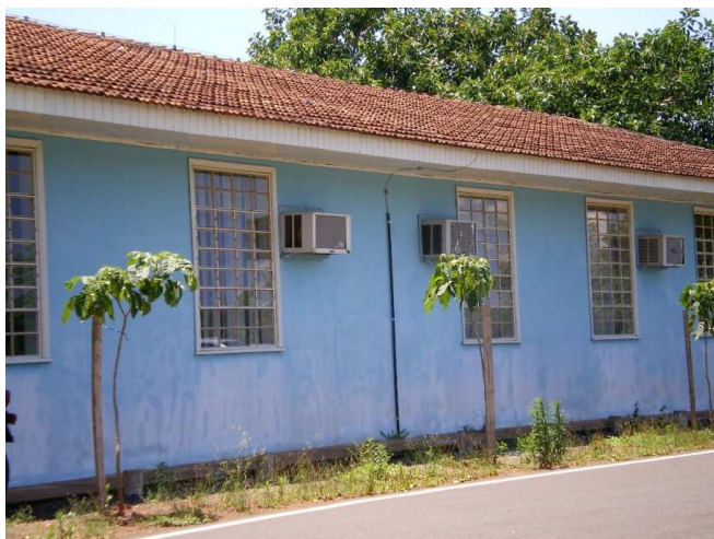
Figura 20: Pintura externa danificada precocemente.
