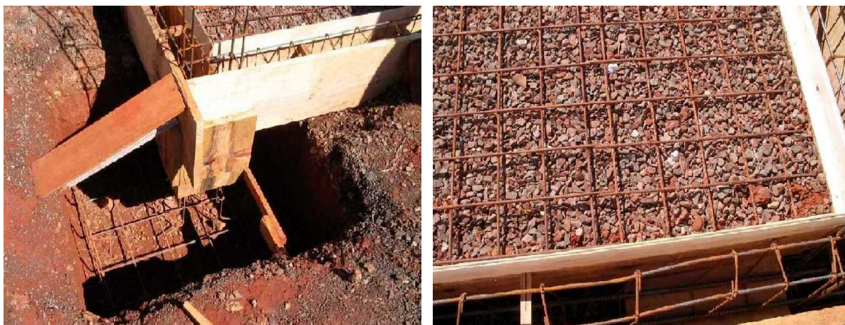
Figuras 15 e 16: Falta de lastro de brita no fundo da sapata e ausência de espaçadores em armadura de piso.
