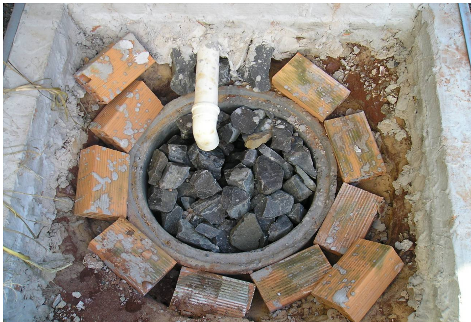
Figura 6 – Sumidouro para infiltração da água no solo.
