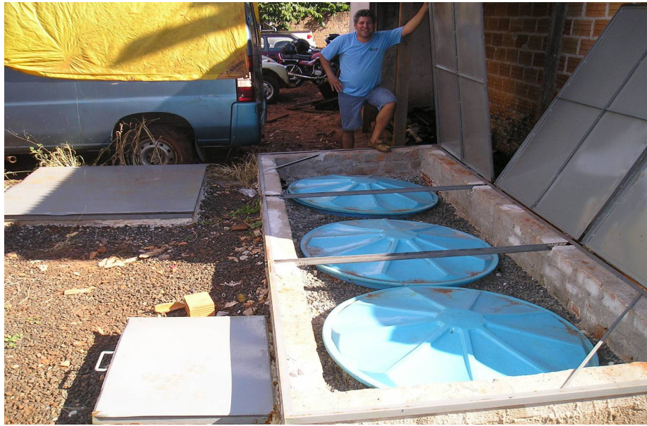
Figura 3 – Sistema de tratamento por decantação de águas oleosas.
