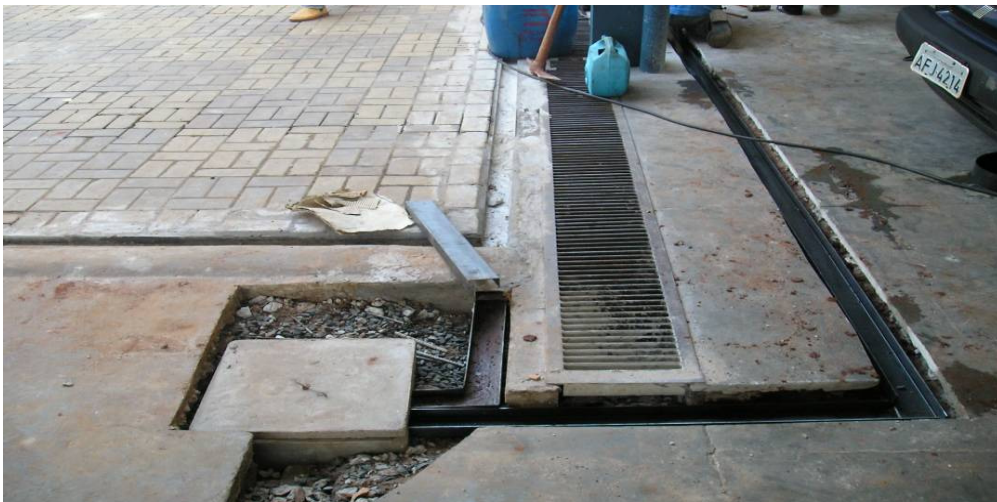
Figura 5 – Canaletas que direcionam a água da lavagem do piso para o tratamento.
